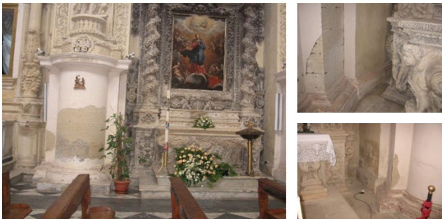
Fig.5 - Diffusi ammaloramenti delle superfici murarie causati dall'umidità capillare.
