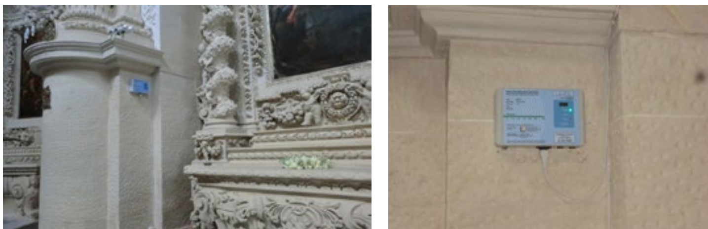
Fig.7 - Installazione dell'apparecchio a neutralizzazione di carica Domodry.
