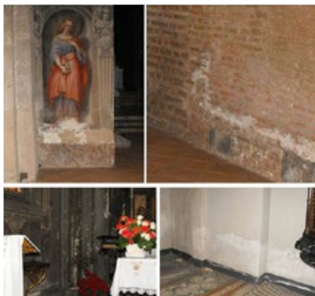
Fig.2 – Alcuni esempi del degrado delle superfici.
